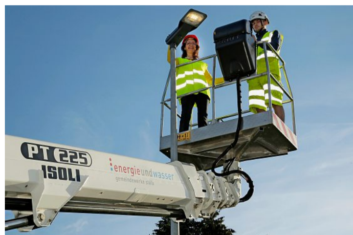
Gemeinderätin Claudia Hollenstein und Netzwerkmonteur Samuel Hauser setzen die erste neue Lampe in Betrieb. Foto: Sabine Rock
